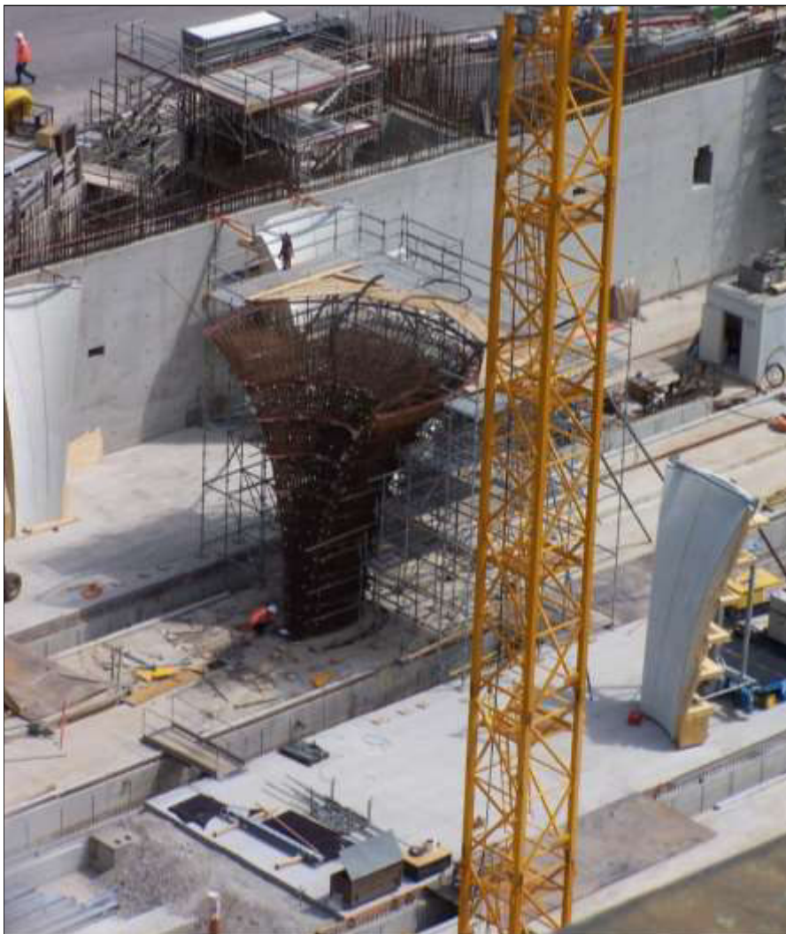
Der 6 Meter hohe Kelchfuß der ersten Stütze ist am 24. Mai 2017 bewehrt; Foto: Martin Ellwanger.
